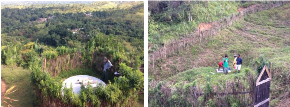
À gauche, réservoir enterré de Tanambaohely et à droite captage de Sahamanoro
