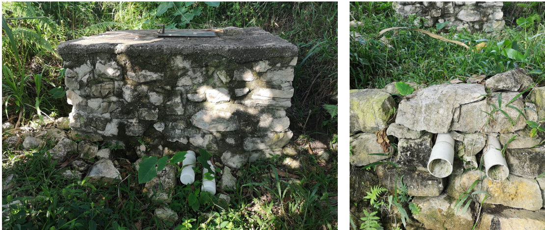
Figure 5 : A droite : la boîte de captage ; A gauche : les trop-pleins
