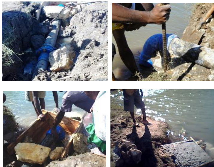
Figure 84 : Fuite engendrée à cause du non-respect des matériaux
