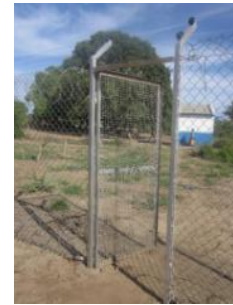
Figure 60 : grillage pour protection des panneaux solaires
