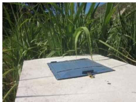
Figure 53 : Protection de forage du chef-lieu Ambohimahavelona
