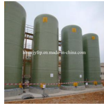
Figure 71 : Réservoir d'eau en fibre de verre
