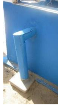
Figure 42 : Conduite de refoulement protégée
