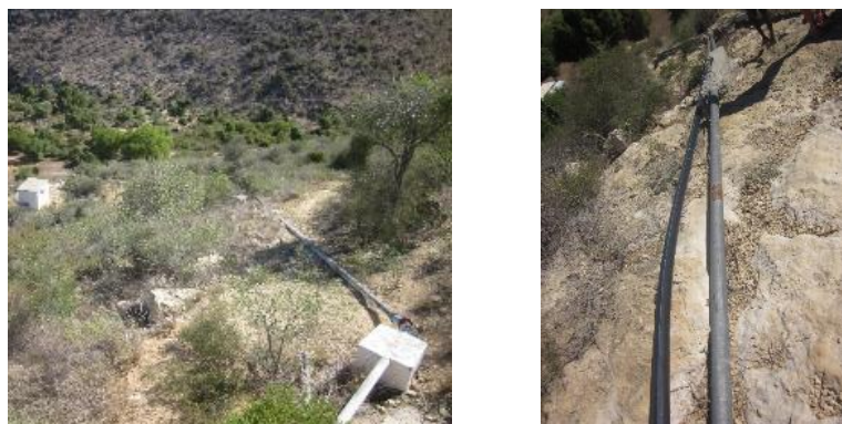
Figure 83 : Conduites de distribution et de refoulement à Saint Augustin
