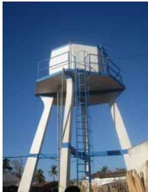
Figure 69 : Réservoir d'eau en béton armé
