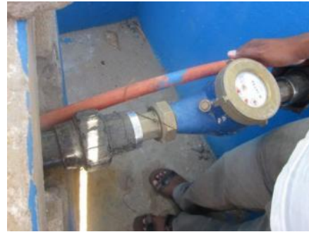
Figure 44 : Compteur de production
