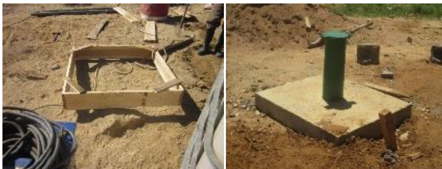
Figure 14 : protection de la tête de forage d'Ankililoaka
