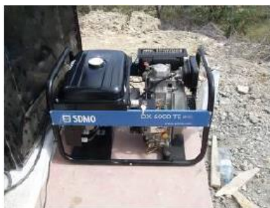
Figure 49 : premier groupe électrogène à Saint Augustin
