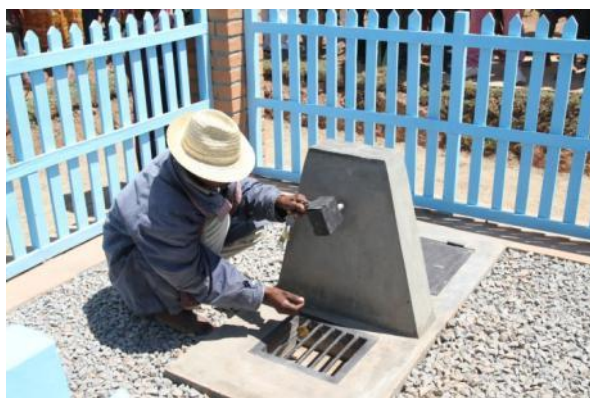
Figure 87 : Exemple de Borne Fontaine (Coopération Grand Lyon- Haute Matsiatra)
