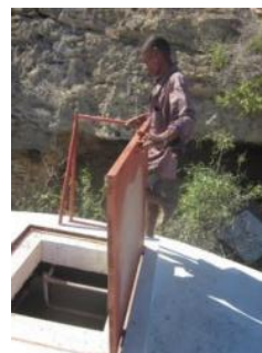
Figure 78 : Trappe de visite
