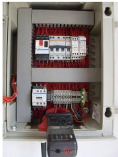
Figure 45 : Vue d'intérieur d'un boîtier de commande d'une pompe standard
