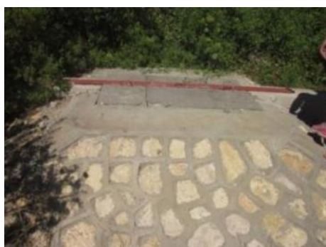
Figure 52 : protection de forage de saint Augustin
