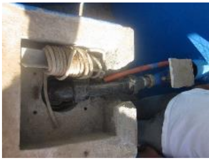
Figure 41 : Coude et début conduite de refoulement
