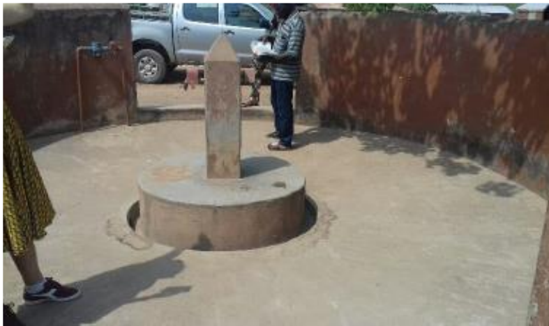
Figure 2 Commune de Dassa au Bénin. Borne fontaine d'un réseau géré par un opérateur privé.
